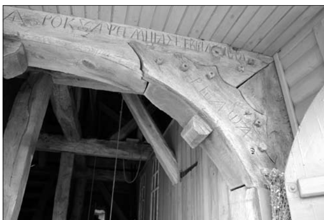
Іл. 10. Фрагмент portalу двоярусної дзвіниці 1801 р. біля церкви Різдва Пресвятої Богородиці 1739 р. у м. Тисмениці того 1806 р. у с. Надорожна Тлумацького р-ну. З нижнього її краю прикріплено дошку з профілями у вигляді стилізованих ламбрекенів, прототипом яких є аналогічна оздоба з тканини. Про імітацію дорогого полотна, яке використовувалось для наметів, балдахинів вельмож, свідчать також імітовані точені «китиці». У церквах св. безсеребр. Косьми і Дем'яна 1888 р. у с. Петрилів, Перенесення мощей св. Миколая 1899 р. с. Олешів «ламбрекени» хорів мають складніший силует, проте без «китиць». Іл. 9.
